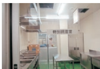
総合調理センターに設置のアレルギー対応調理室
